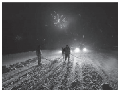
春节的烟花绽放夜空,泰兴市公路管理站的工人在路面铲雪。
